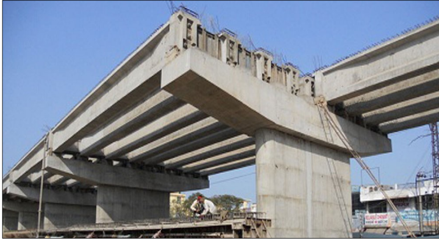
รูปที่ 7.3.2-1 สะพานคอนกรีตอัดแรงรูปตัวไอ (Prestressed Concrete I-Girder)
