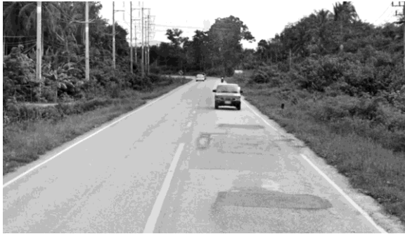
ทางหลวงแผ่นดินหมายเลข 4085 (ช่วง กม. 0+921 ถึง กม. 3+000)
